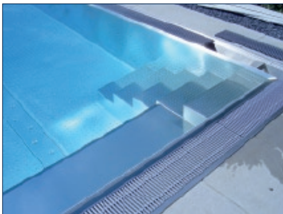
Einstiegstreppe mit Sitzbank und Bodendüsenkanal
