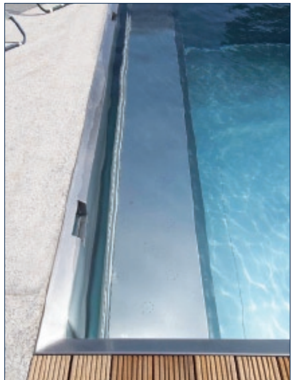
Skimmer (Eigenfertigung), Unterflurrollladenabdeckung mit Sitzbank und Luftsprudelsystem
